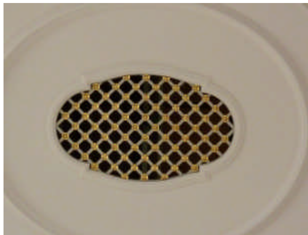
(Abb 15) Das Schalloch des Fernwerks ist gleichzeitig Entlüftungs- und Entrauchungsöffnung.
