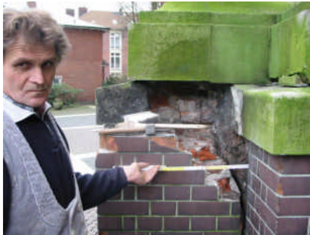
(Abb 4) Ablösung der Mauerschale von 1908
