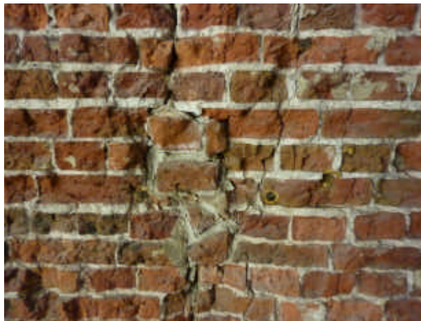
(Abb 5) Gipshaltiger Mörtel im barocken Mauerwerk
